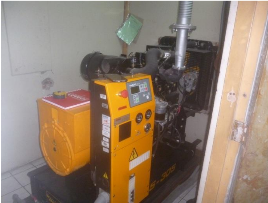
GRUPO ELECTRÓGENO DE 30 KW.
